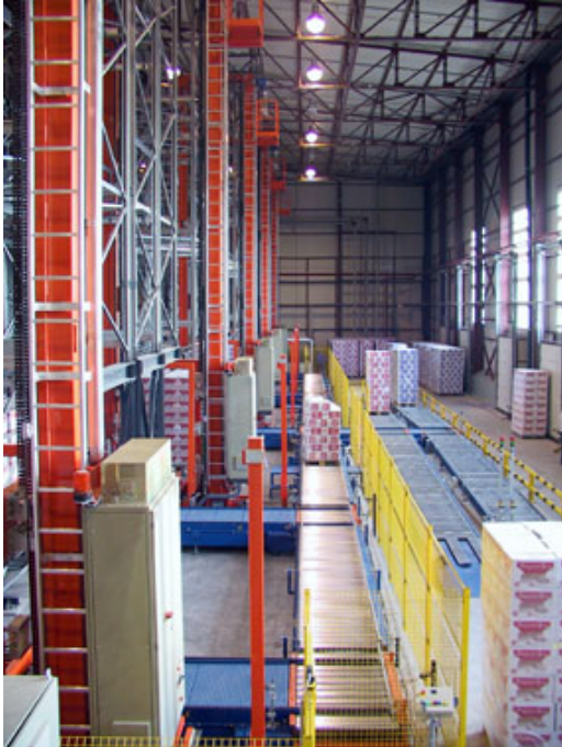
Ergänzung durch verschiedene Förderanlagen
